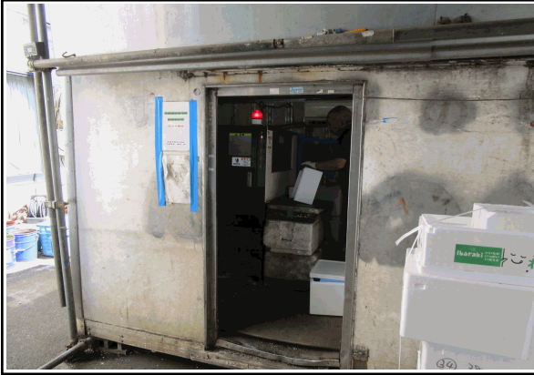
処分を行う事業場(その2)における施設の現況 ①施設の外觀(施設名称:発泡ヤード)
