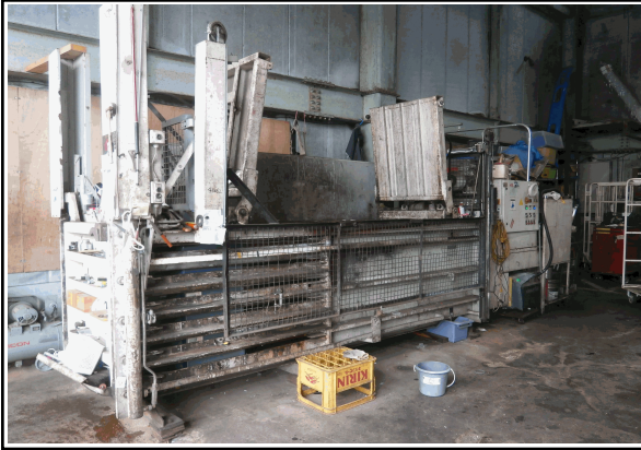
処分を行う事業場(その4)における施設の現況 ①施設の外觀(施設名称:圧縮・梱包)
